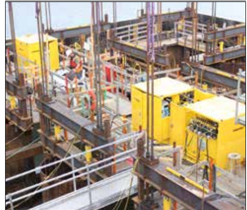
▲ Zakázkové hydraulické čerpadlo pro systém ukládání mostovek.
